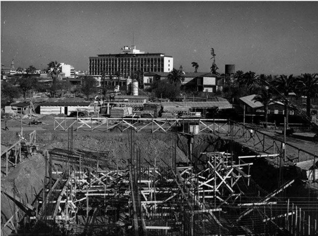
Cimientos de la Torre 13 de la Remodelación San Borja, al fondo la Posta. Fotografía vía Santiago Nostálgico.
